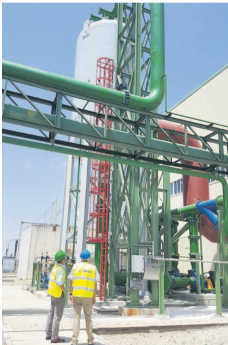
El ciclo higroscópico instalado por Imasa en la central de Palencia.
